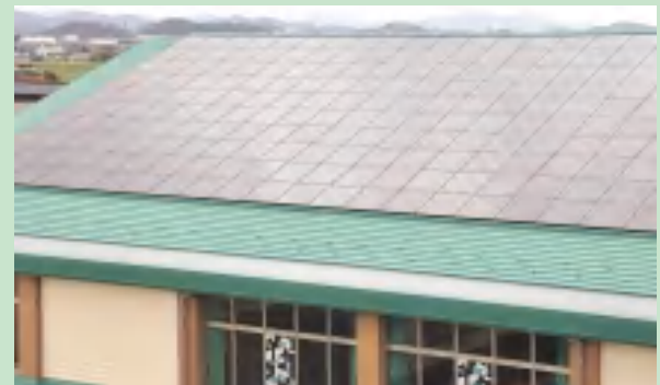
■太陽光パネル
